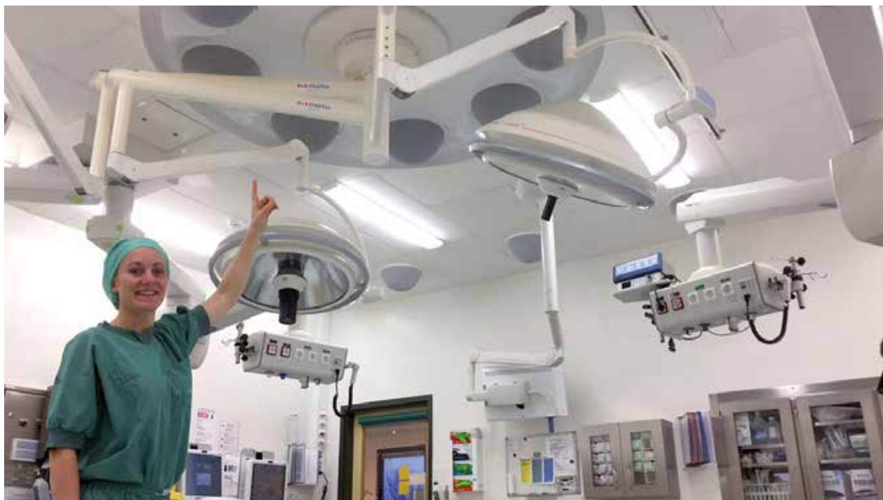
Malin Alsved, doktorand i aerosolteknologi vid Lunds Tekniska Högskola, i salen med temperaturkontrollerad ventilation på Helsingborgs Lasarett.
